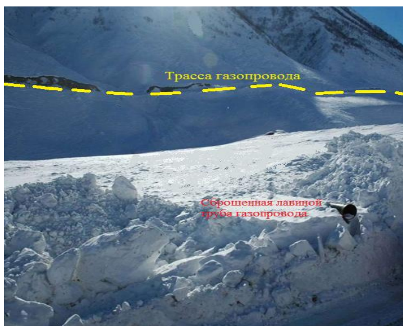
Рисунок 3.22 – Последствия для газопровода схода лавинного очага №67 разрыв и сброс вниз к реке 150м. (фото Чотчаева Х.О., ноябрь, 2011г)
